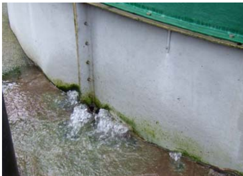
Figur 22: Lekkasje fra sprukket kar
