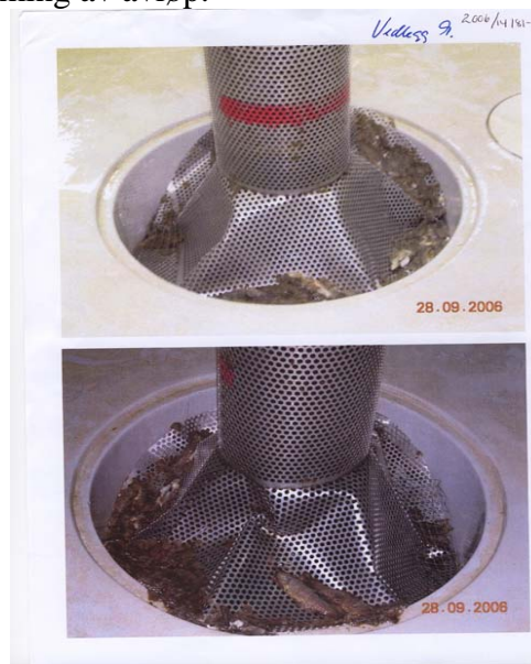
Figur 3: Sil etter kollaps
