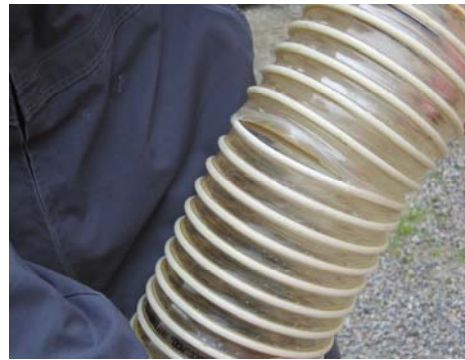
Figur 29: Fleksibel slange med sprekk
