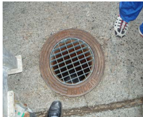
Figur 20: Avløp/rist med for stor lysåpning
