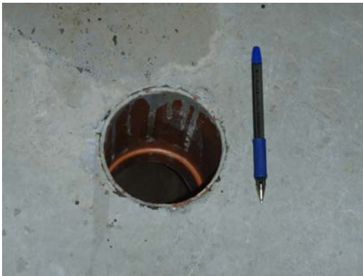
Figur 19: Usikret avløp i gulv
