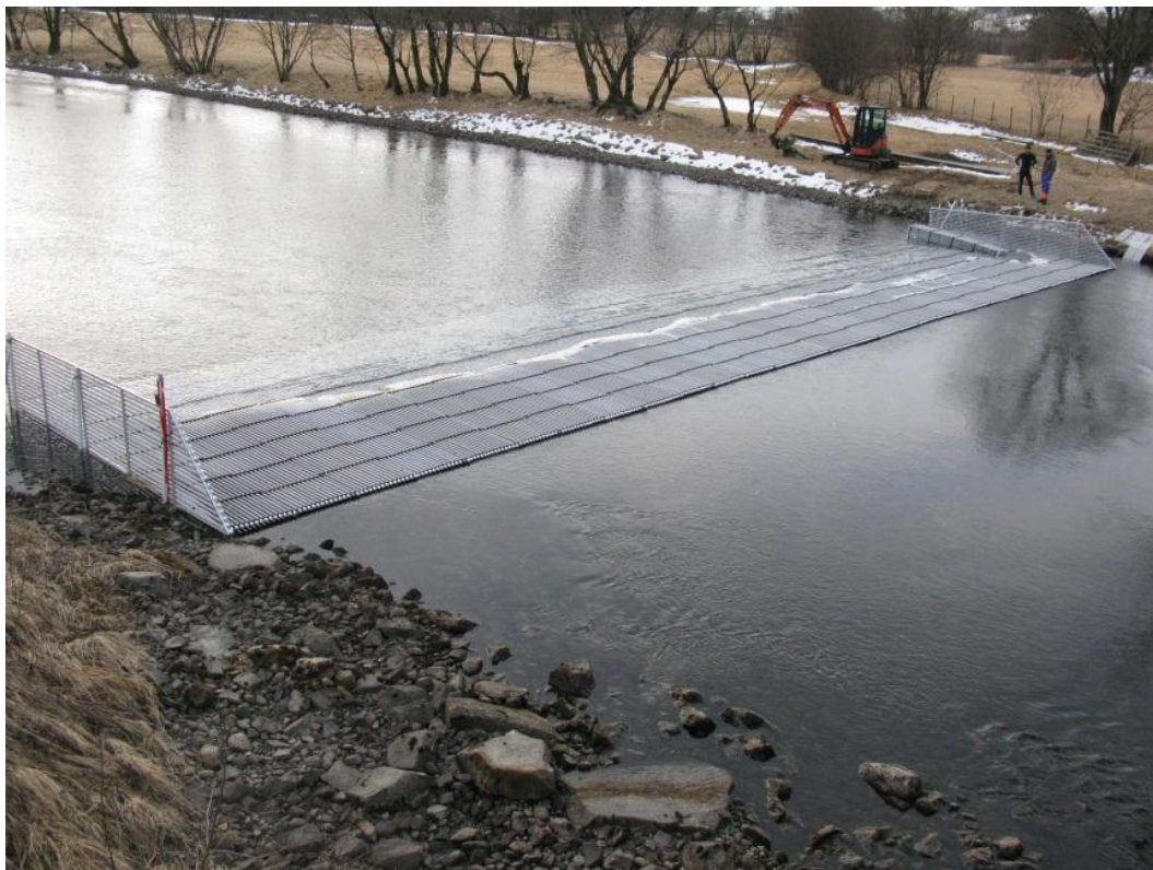
Figur 13. “Resistance Board Weir” installert i Etne. Dette er det første “flytende elvegjerdet” installert i Europa (Foto: Ø. Skaala).
