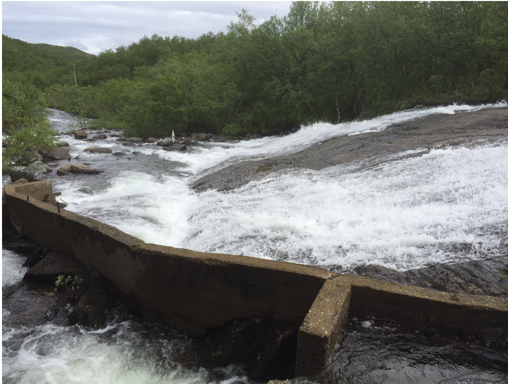
Figur 3. Vandringshinder med gammel defekt laksetrapp i Friarfjordelva
