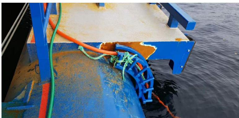
Figur 5 Kabelchute for hovedstrømkabel
